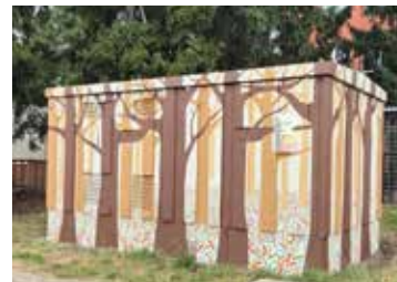
| ↑ | MURAL NA TRAFOSTANICI
